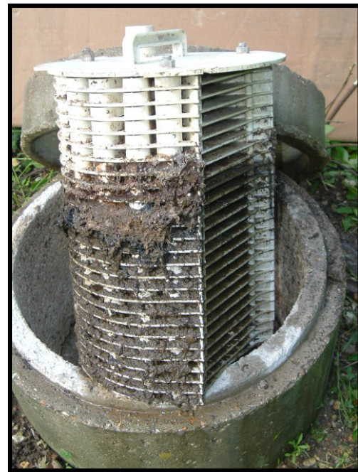
A dirty effluent screen.
